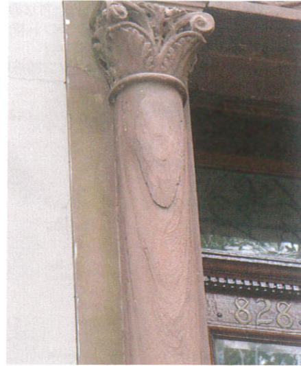
写真⑩ 石目に沿って生じた割れ。ブルックリンのクラウン・ハイツ地区の建物(2011年に筆者が撮影)。
