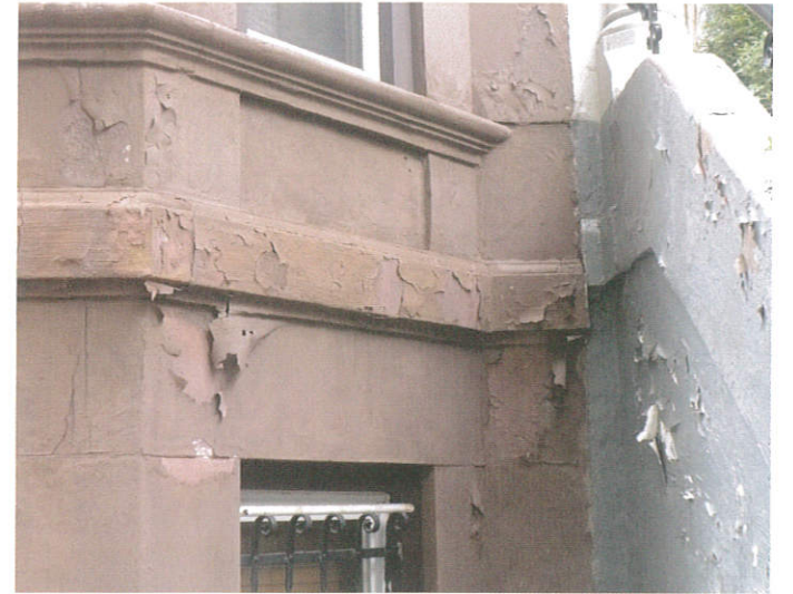
写真⑪ 石の上に施された塗装の剥がれ。ブルックリンのクラウン・ハイツ地区の建物(2011年に筆者が撮影)。
